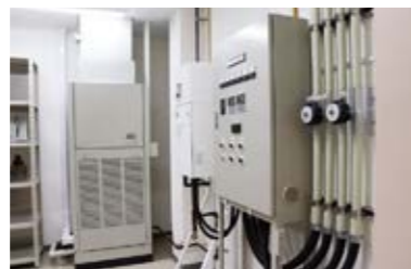
設備用エアコン
